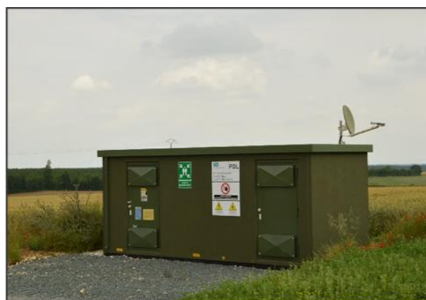
Photographie 71 : Exemple d'un poste de livraison vert sombre.
