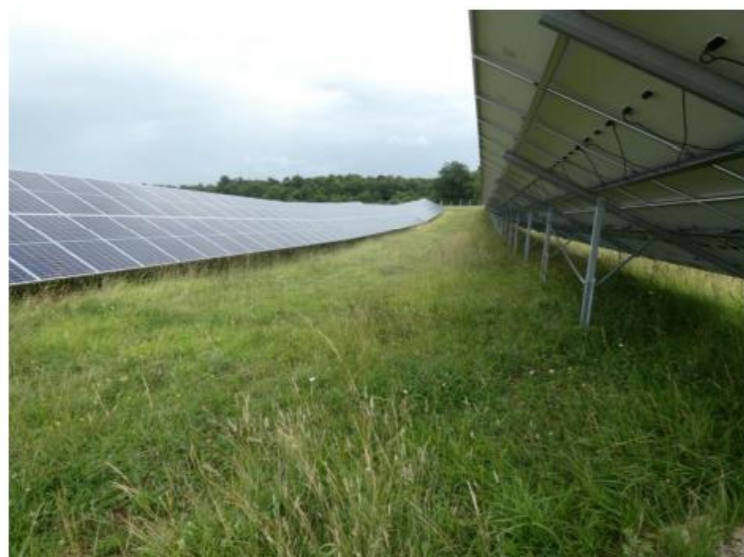
Photographie 66 : Illustration de ce que pourrait être le futur parc photovoltaïque en exploitation (Source : SIMETHIS)
